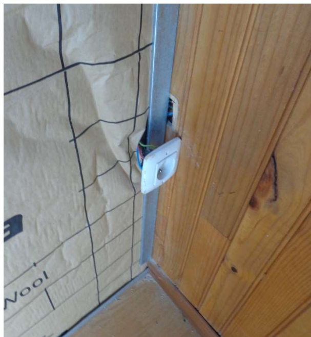
Risque électrique constaté chez un particulier dans la Marne, après une intervention isolation à 1 €
